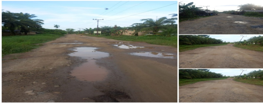
Gambar 2. Kondisi Akses Jalan Lintas Desa Bagan Bilah Yang Rusak
