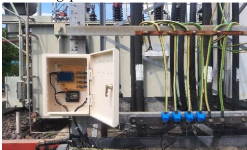
Monitoring Arus Bocor pada Trafo 20 kV
